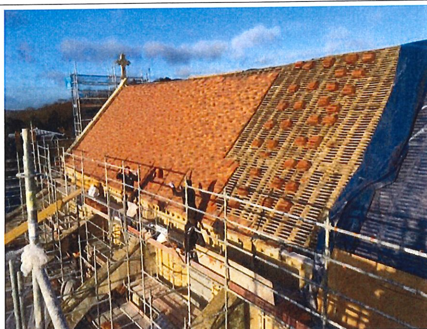
Vue des travaux de couverture en cours sur la nef en décembre 2018.
